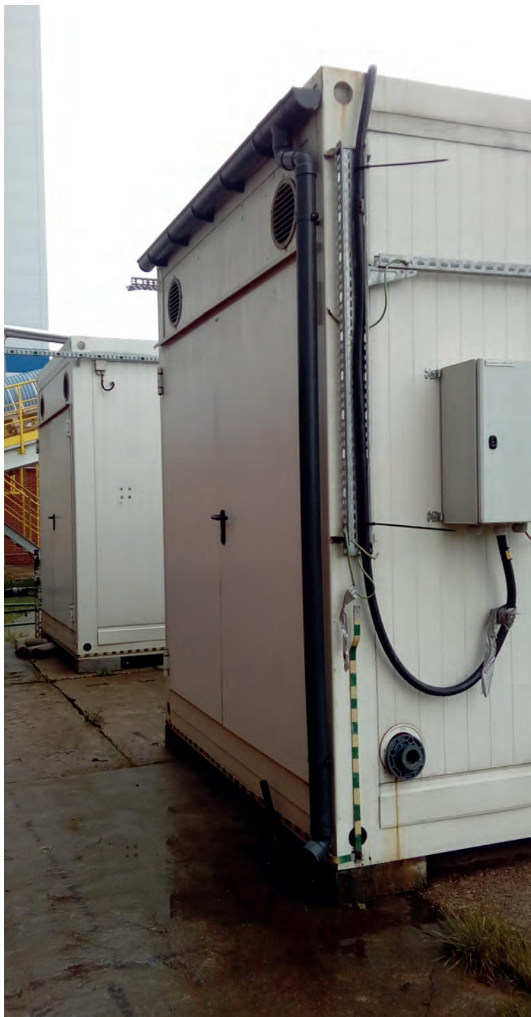
FOT. 3 Instalacja pilotażowa usuwania metali z wykorzystaniem żywic jonowymiennych – kontenery badawcze
