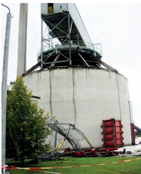
FOT. 1 Silos do przechowywania peletu RDF po wybuchu (fot. J. Januszewski)
