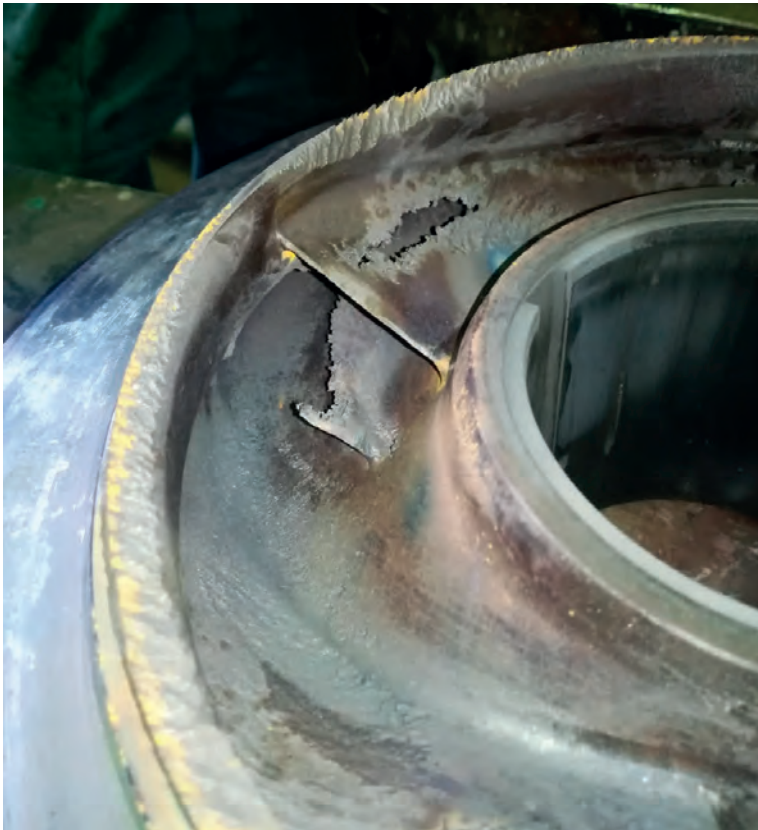
FOT. 2 Uszkodzenia kawitacyjne łopatek na wlocie wirnika pompy zasilającej po 8 latach pracy w różnych stadiach kawitacji początkowej; co druga łopátka jest cofnięta w głąb wirnika wykonanego ze staliwa chromowego GX20Cr14 (dawne oznaczenie LH14)
