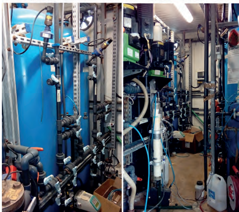
FOT. 1 Instalacja pilotażowa – usuwanie metali z wykorzystaniem żywic jonowymiennych – wewnątrz
