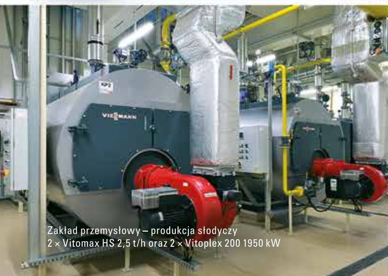
Kotłownia kontenerowa przy spółdzielni mleczarskiej Vitomax 200 HS
