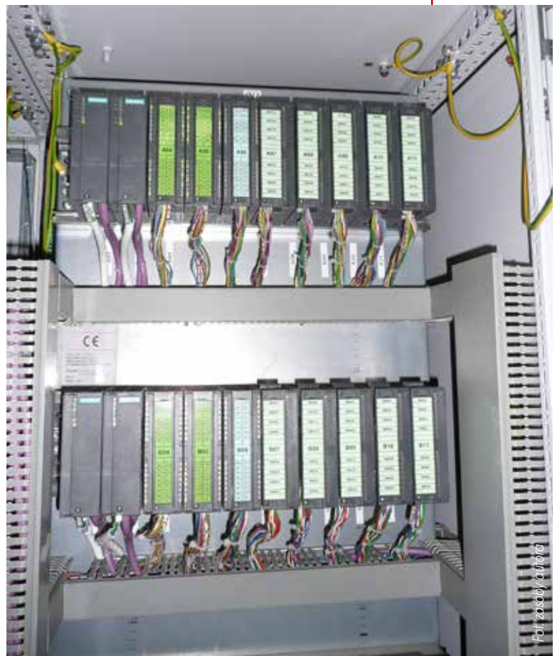
FOT. 2 Szafa sterownicza sterownika modułowego
