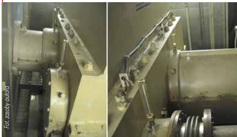
FOT. 1 Widok na przednią i tylną stronę przekładni
