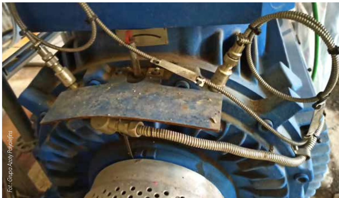
FOT. 1 Zdjęcie przedstawiające błędną orientację czujników sejsmicznych drgań oraz czujnika temperatury na silniku pompy depropanizera
