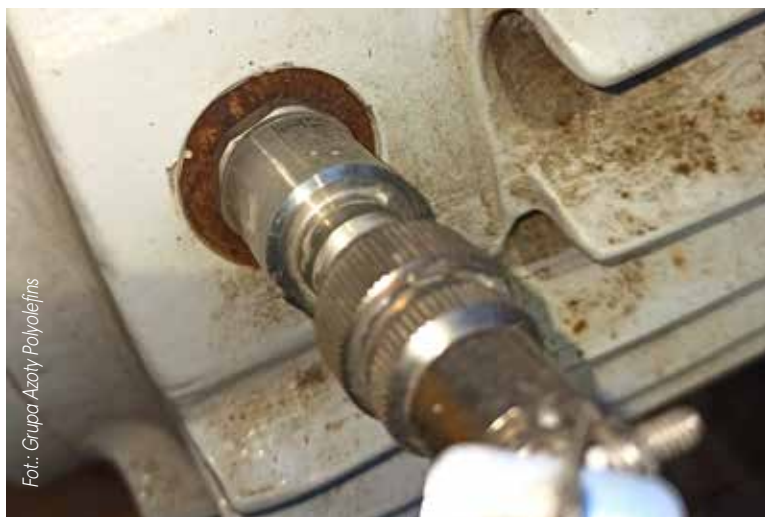
FOT. 2 Zdjęcie przedstawiające skorodowaną powierzchnię montażu czujnika sejsmicznego na pompie cyrkulacyjnej wody
