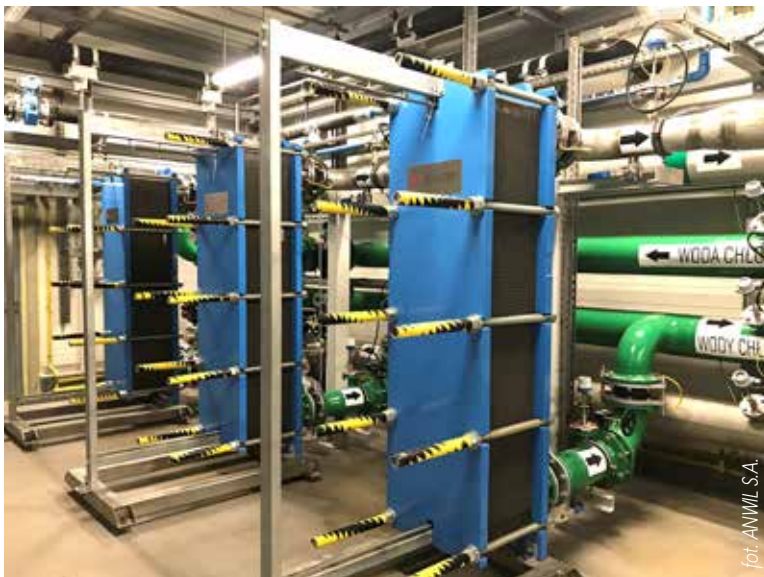
PIERWSZYM ETAPEM produkcyjnym jest WPWS – wstępny podgrzew wody surowej
