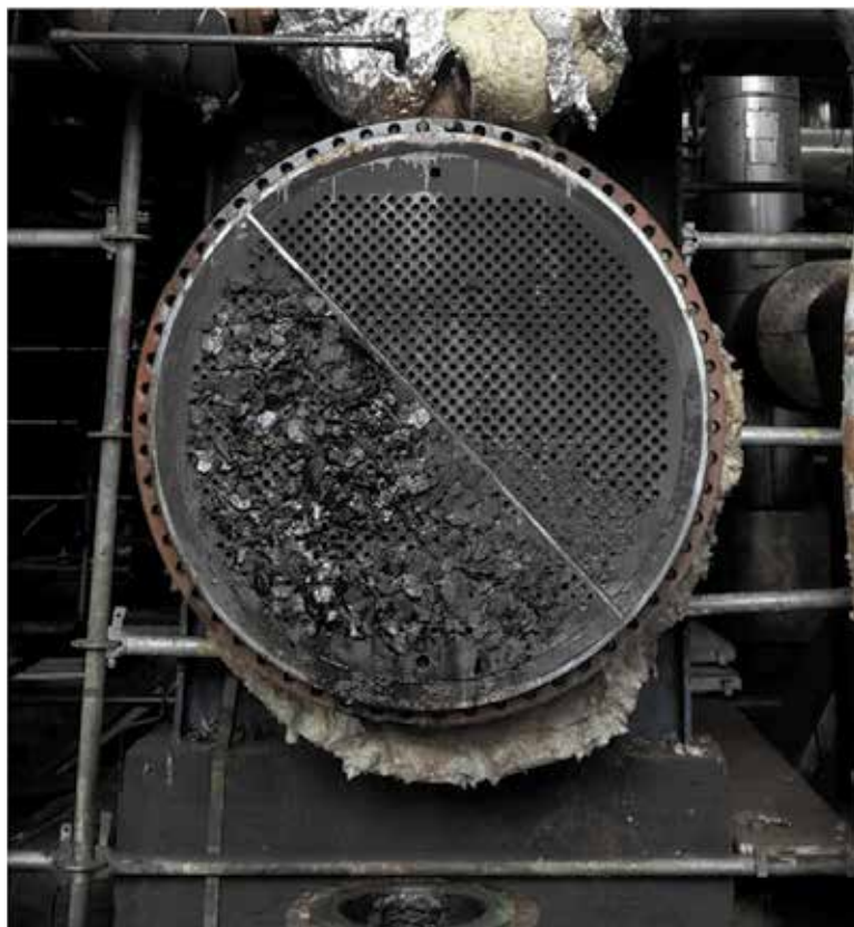
FOT. 1 Osad skumulowany w obrębie płyty sitowej wymiennika ciepła
